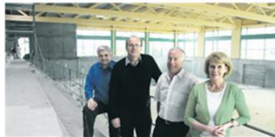
Sous les impressionnantes poutres de la future salle de sport, le couple Anne-Marie et Neil Harwood, Jean-Louis Dubler (3 des 4 directeurs de l'école) et le syndic de St-Légier Alain Bovay. P. Hess
